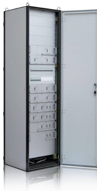
Шкаф управления АБТЦ-И
