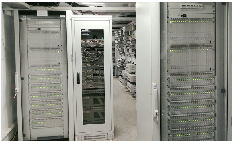
Оборудование МПЦ-И на станции Кото Дальневосточной дороги
