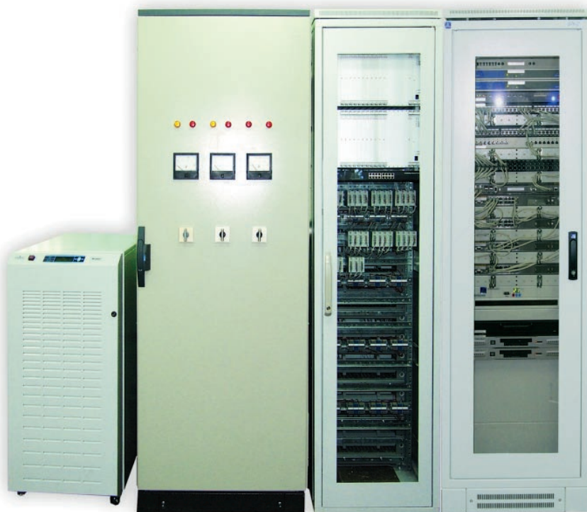
Рис. 1. Постовое оборудование МПЦ-И
