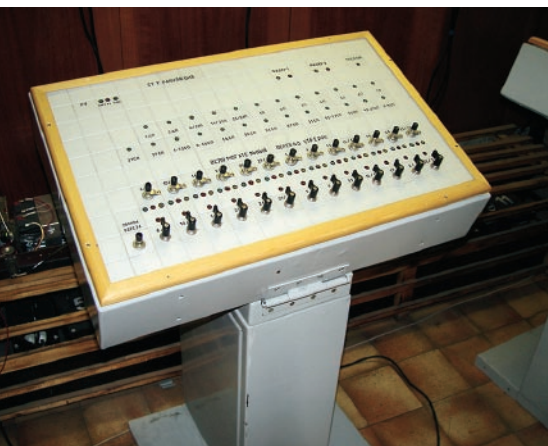
Рис. 4. Пульт резервного управления
