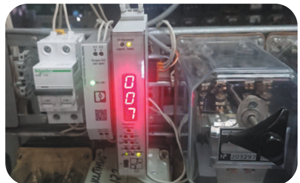
BI Interfacing Unit
