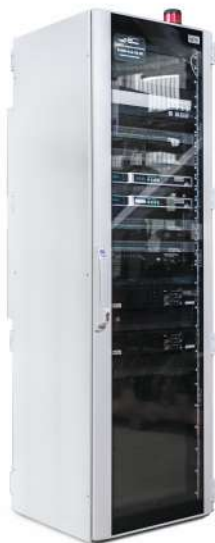
Шкаф телекоммуникационный ШТК
